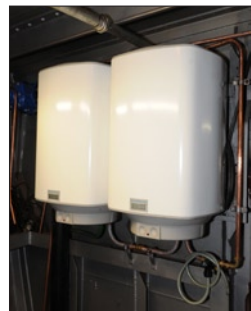
Boilers in de technische ruimte op het tussendeck.
