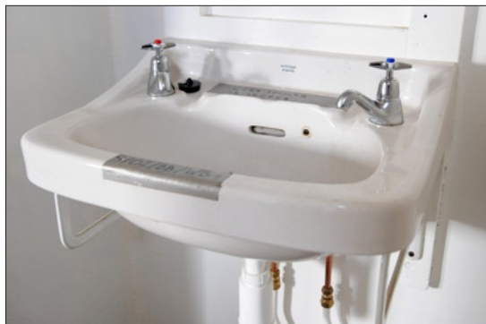
Wastafel in de herstelde wasruimte van de hoofdmachinist.
